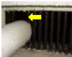
壊れた床下の通気口
